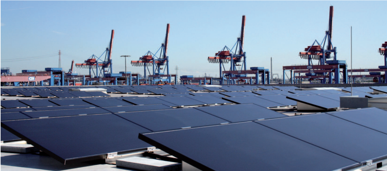
Die BALTICSOLAR Anlage auf dem Dach des Logistikzentrums Altenwerder zeigt die Integration umweltfreundlicher Energieerzeugung in die bestehende Hafenlandschaft des Hamburger Hafens.
