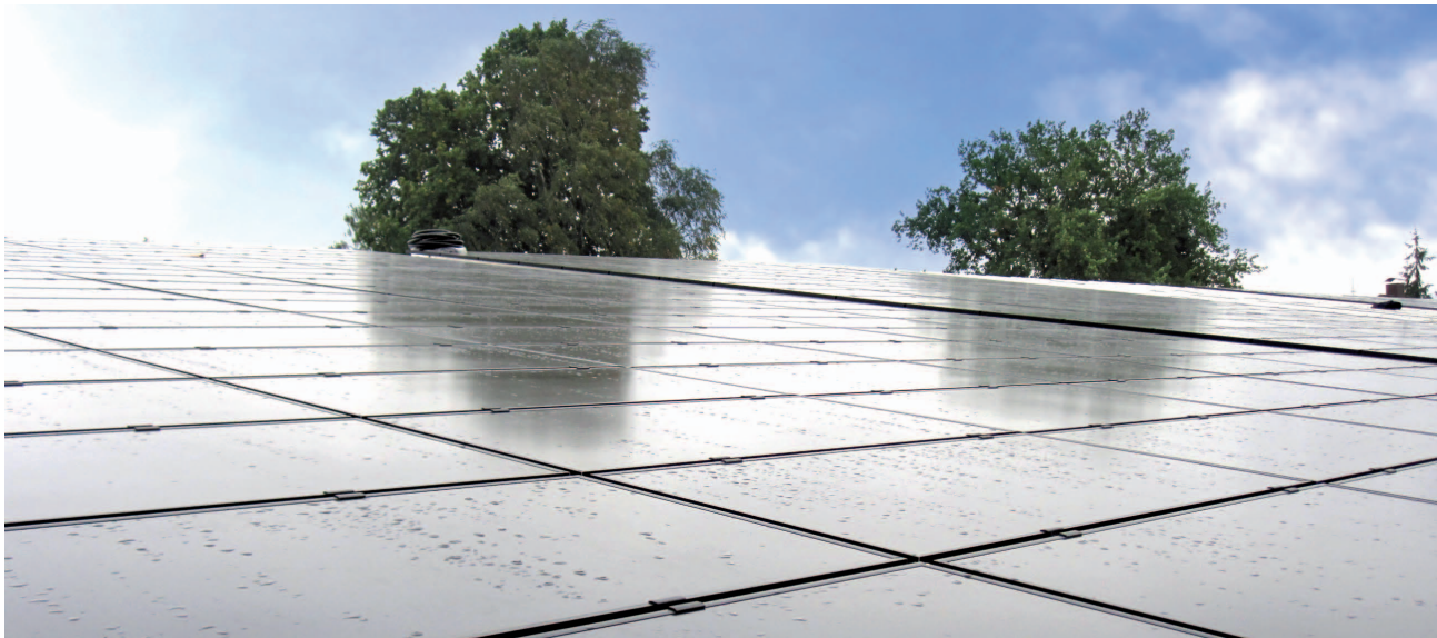
Die Solaranlage von BALTICSOLAR in Wankendorf beweist, dass auch auf Ost- und Westdächern hohe Stromerträge erzeugt werden können.
