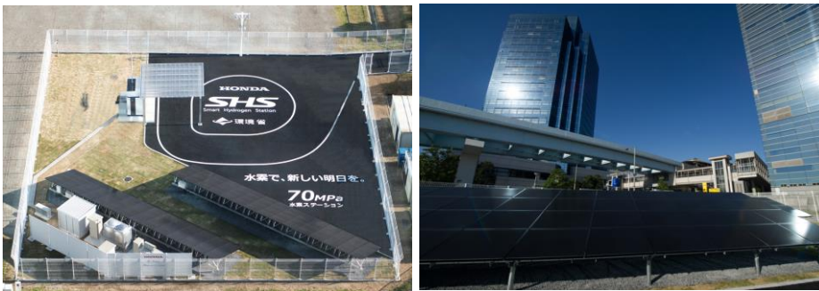
CIS-Module von Solar Frontier, installiert auf einer intelligenten 70-MPa-Wasserstofftankstelle
